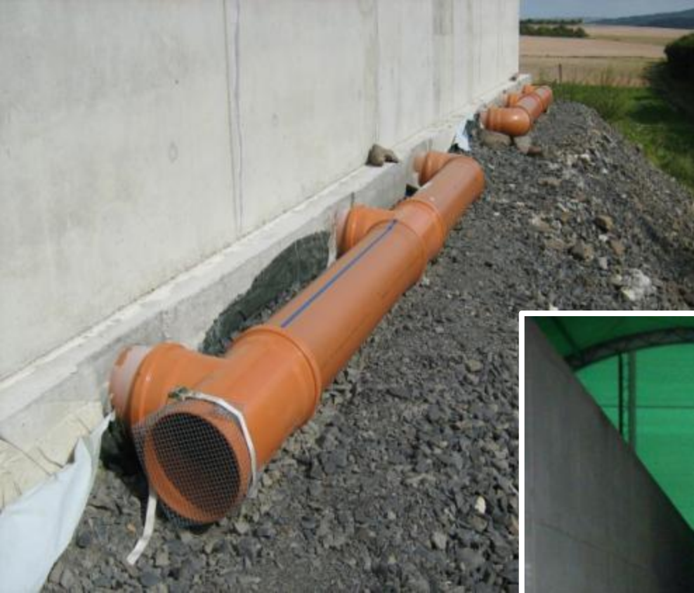
Links: Kanalanschlußrohre zur Belüftung je Zelle
